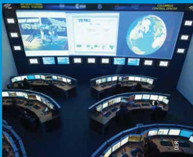
↑ Salle de contrôle du Centre de contrôle Columbus
